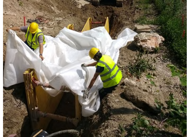
Abb. 2: Mit einem weißen Fleece als Trennmateriale sorgen die Arbeiter dafür, dass sich Kies und feinerer Boden im Deich nicht vermischen können. Würde sich der feinere Boden in den Kies einlagern, könnte das Wasser nicht mehr ablaufen.
